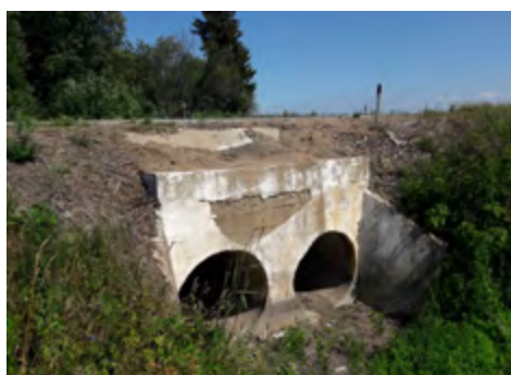
Рисунок 6.4. Дорожная дамба с водопропуском на р. Сумка ниже д. Волпи. Отсутствие стока
